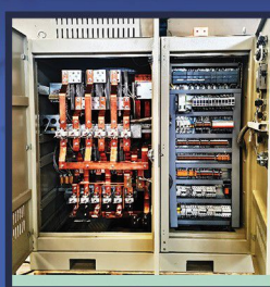
EPC منبع تغذیه DC الکتروکلریناتور در پروژه
